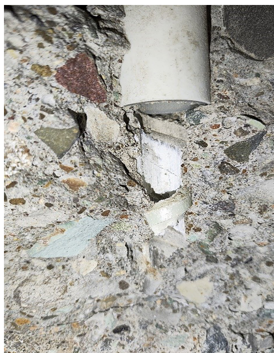
شکل ۱۴- مقطع عرضی محل شکست
