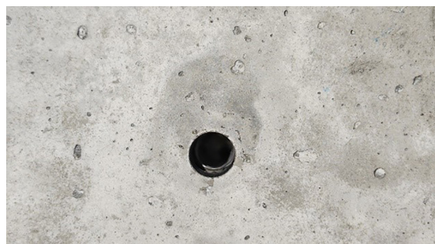
شکل ۱۱- حفره باقی‌مانده از قرارگیری میلگرد کامپوزیتی در نمونه کنترل، پس از انجام آزمایش و خارج‌سازی میلگرد از بلوک بتنی.
